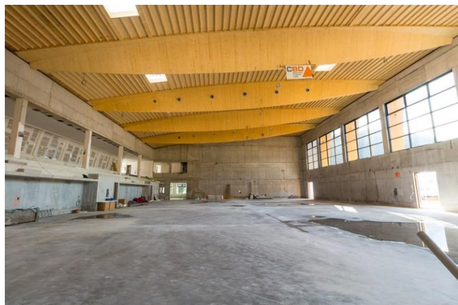
Slika 3: Vsi objekti srednješolskega centra v Slov. Gradcu bodo iz armiranega betona, obdani s kameno volno, lesen bo le zgornji del oz. strop telovadnice na sliki. Tudi tu so grobo kršili Uredbo o ZJN.
