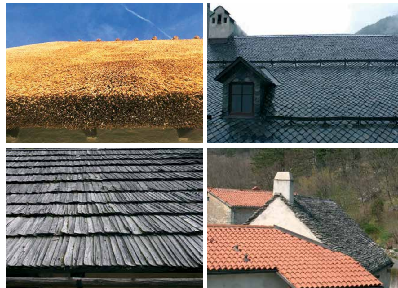
Slike 13 - 16: Poseganje v historično kritino in strešno konstrukcijo lahko povzroča nepovratne izgube varovanih sestavin, foto T. Hohnc
