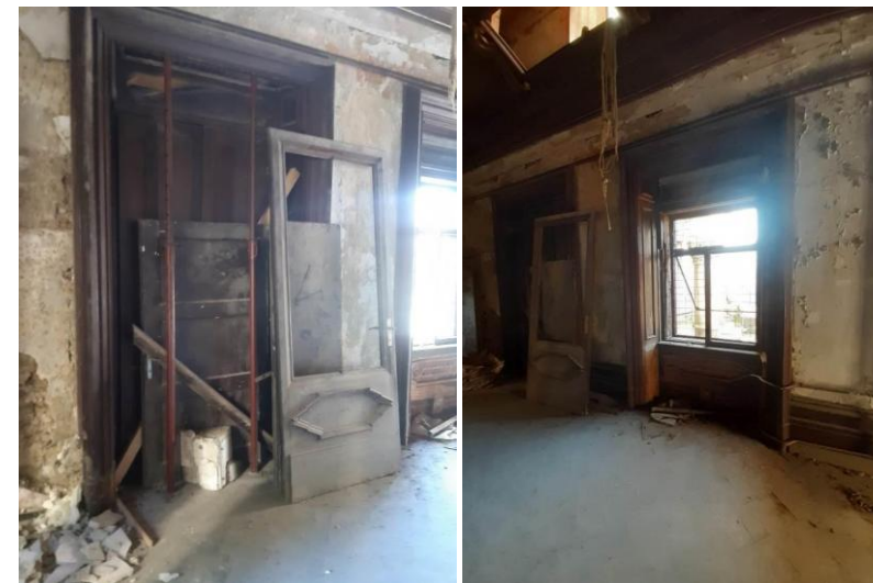
Sliki 4 in 5: Stanje stavbnega pohištva v prvem nadstropju ob ogledu 15.3.2021.
