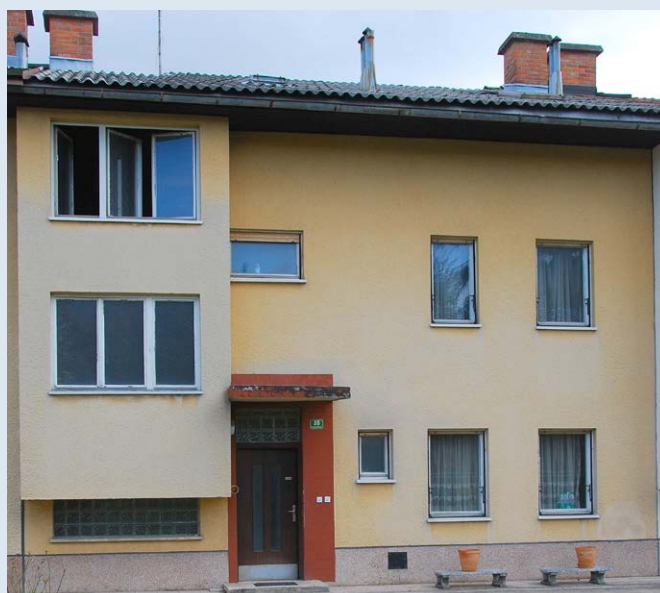
Slika 11: Sprednja fasada je oslABLJENA s številnimi odprtini.
