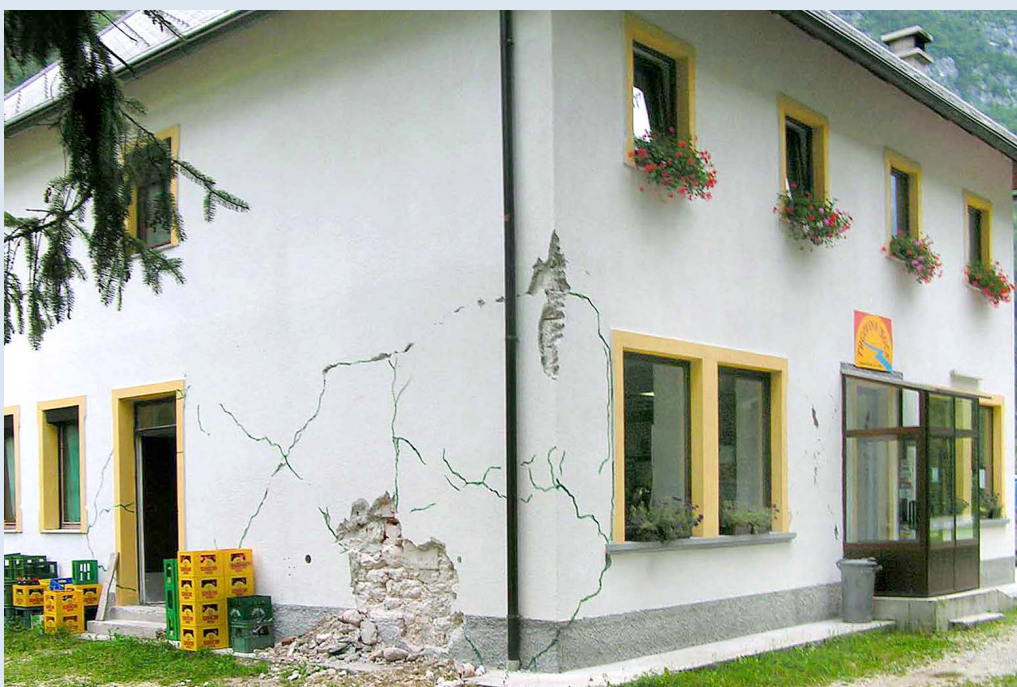
Slika 26: Po potresu poškodovano nadstropje kamnite hiše je bilo na novo sezidano s sodobnimi opečnimi votlaki, kamnito zidovje v pritličju pa ni bilo ustrezno utrjeno. Med ponovnim potresom je hiša utrpela hude poškodbe le v pritličju.
