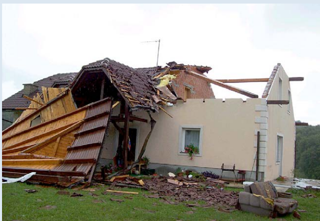
Slika 31: Pomanjkljivo sidranje ostrešja v zidano konstrukcijo.
