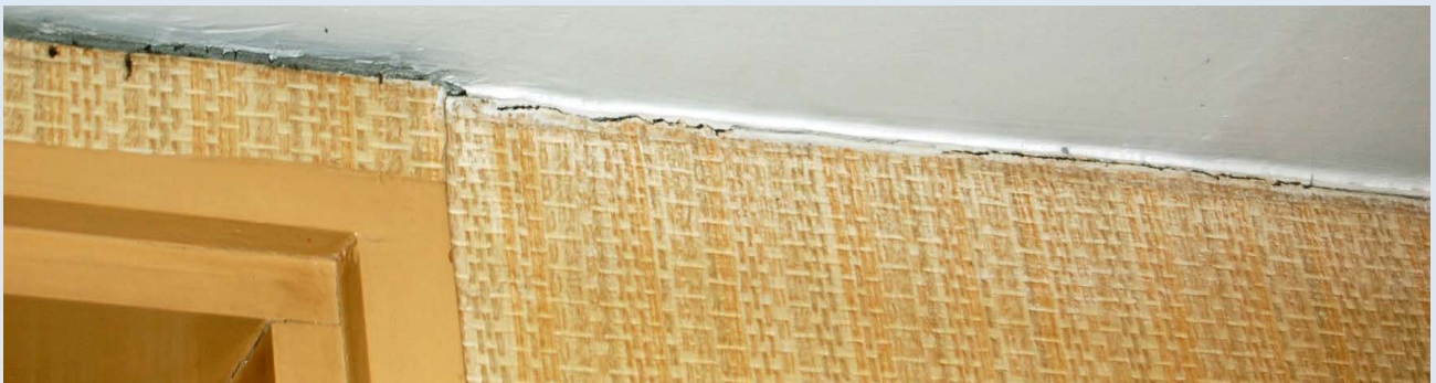
Slika 8: Razpoka na stiku stene in stropa zaradi čezmernih povosov preklade pod steno.
