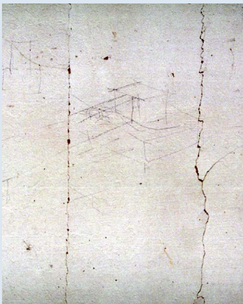
Slika 19: Razpoke na stiku stebra in polnilnega zidu zaradi neprimerne načina rušenja AB nosilca.
