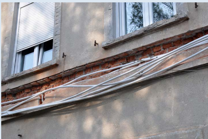
Slika 1: Oslabitev zunanjega zidu s preglobokimi utori.
