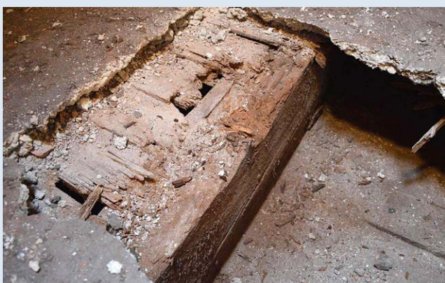
Slika 21: Propadanje poveznika zaradi neustrezne izvedbe zračnika.
