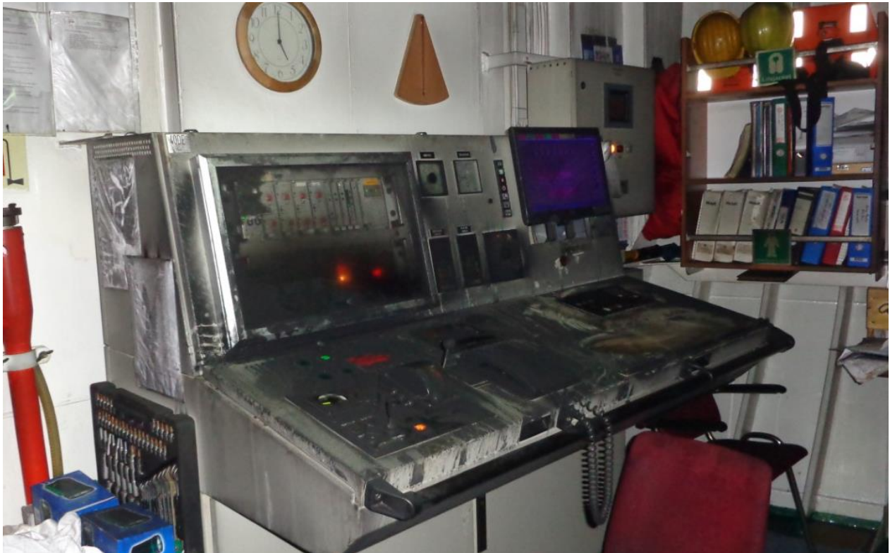
Slika 3: Poškodba komandne konzole strojnice
