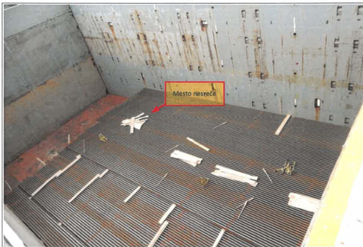
Slika 1: Mesto nesreče, skladišče st.2 z leve strani
