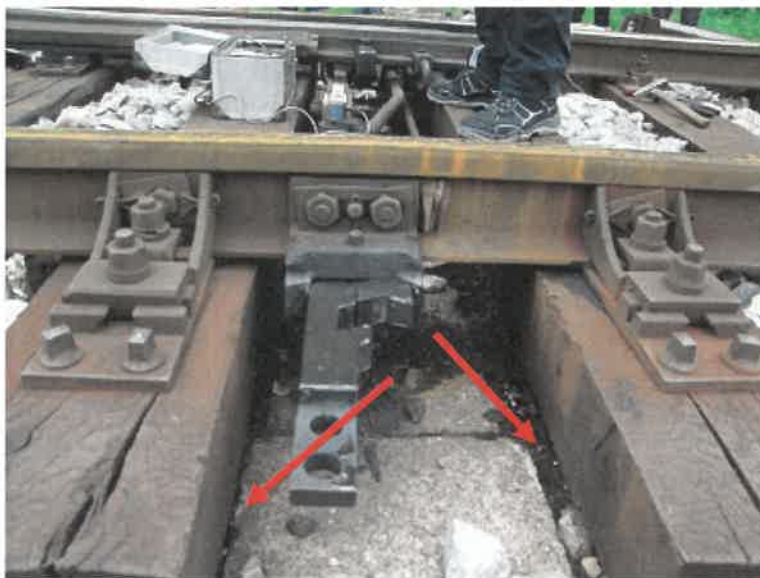
Slika št. 4: Rdeči puščici označujeta pomanjkljivo nasutje gramozne grede na mestu slepe usedline
