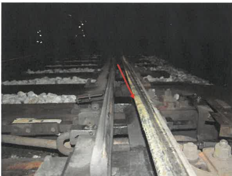
Slika št. 5: Rdeča puščica označuje sled naplezanja kolesa v žleb med ostrico in osnovno tirnico v km 594+239
