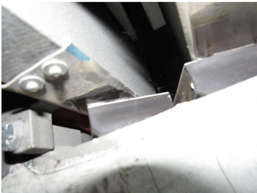
Slika 13.4: Primer neustrezne zasnove krmilnega sistema gredne lamelne dilatacije – nedopustni zasuki ležišč
