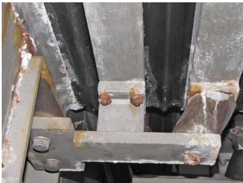
Slika 13.1: Primer posledic neustrezne (preširoke rege) prednastavitve lamelne dilatacije – krmilni mehanizem odpoveduje, netesnost stika elastomernega traku (izvlek iz utora iz čeljusti)
