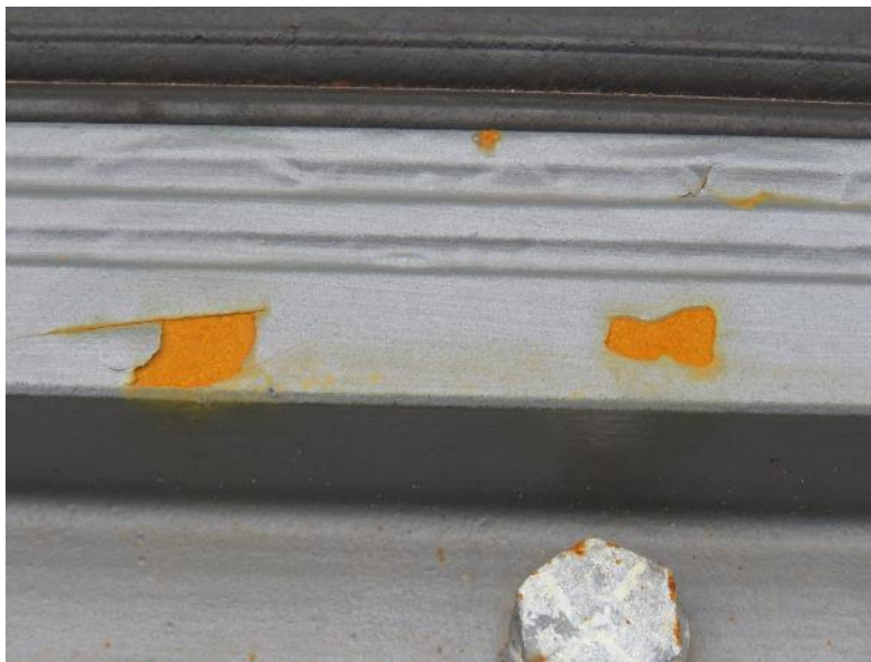
Slika 13.24: Poškodbe protikorozijske zaščite jeklenega robnega profila železniške blazinaste dilatacije zaradi nepravilnega skladiščenja
