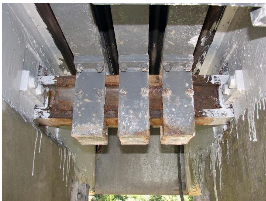
Slika 13.31: Resne poškodbe drsnega sistema lamelne dilatacije zaradi vodonetnosti tesnilnih trakov
