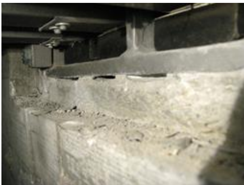
Slika 13.8: Primer škatle krmilnega sistema (grednega) lamelne dilatacije – porozna mesta betona pod škatlo
