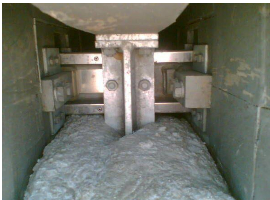
Slika 13.10: Pri betoniranju je popustil opaž, beton je prodrl v škatli in oblil streme z drsnimi ležišči in vzmetmi ter prečno gredo - lamelna dilatacija ne more delovati
