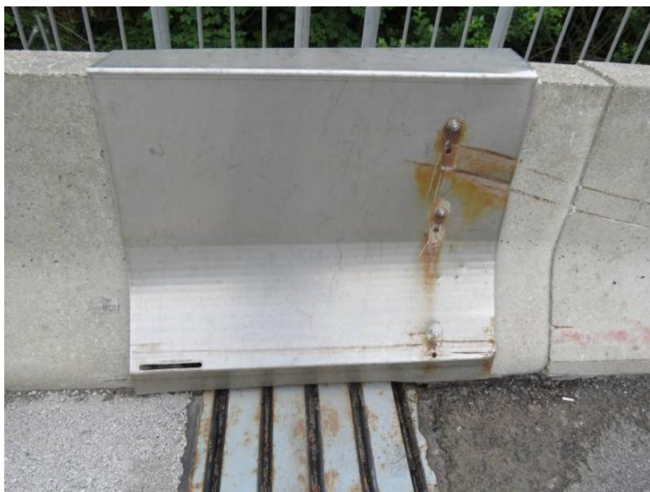
Slika 13.37: Korozija vijakov krovne pločevine ob dilataciji z betonsko varnostno ograjo
