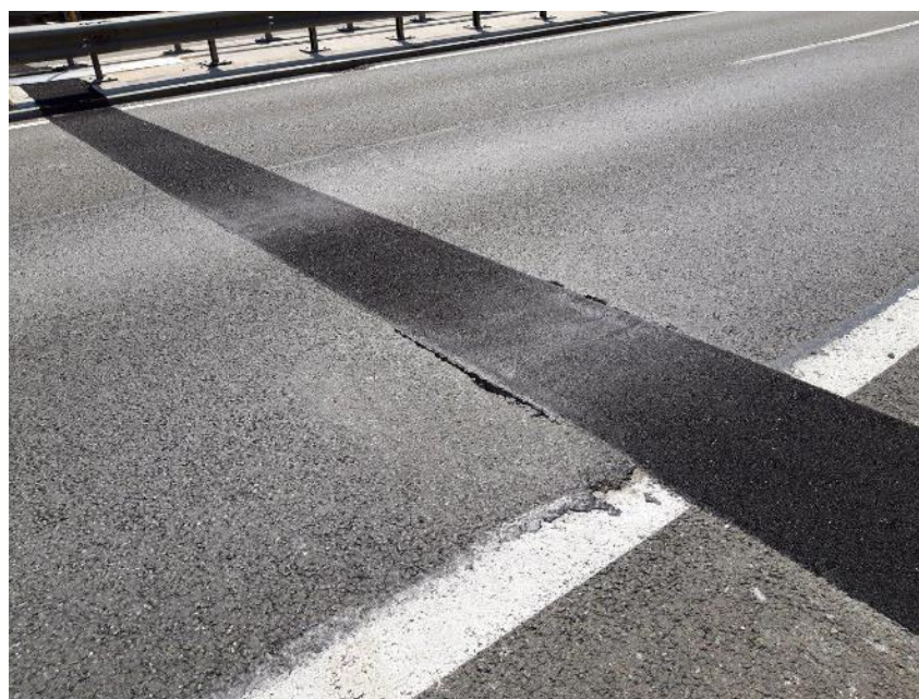
Slika 13.18: Poškodbe polimernih fleksibilnih dilatacij zaradi nezdržljivosti stikov z asfaltnim voziščem
