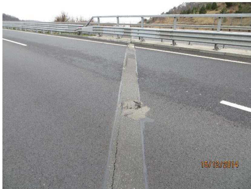
Slika 13.19: Poškodbe polimernih fleksibilnih dilatacij zaradi dotoka pronicujoče vode iz gorvodnega asfaltnega vozišča
