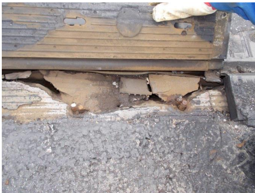
Slika 13.6: Primer poškodbe zaradi neustreznega (enorednega točkovnega) sidrnega sistema dilatacije – lom spodnjega robnega profila betona in povezave z blazinasto ploščo, kljub dodatnim sidrom ob obstoječih
