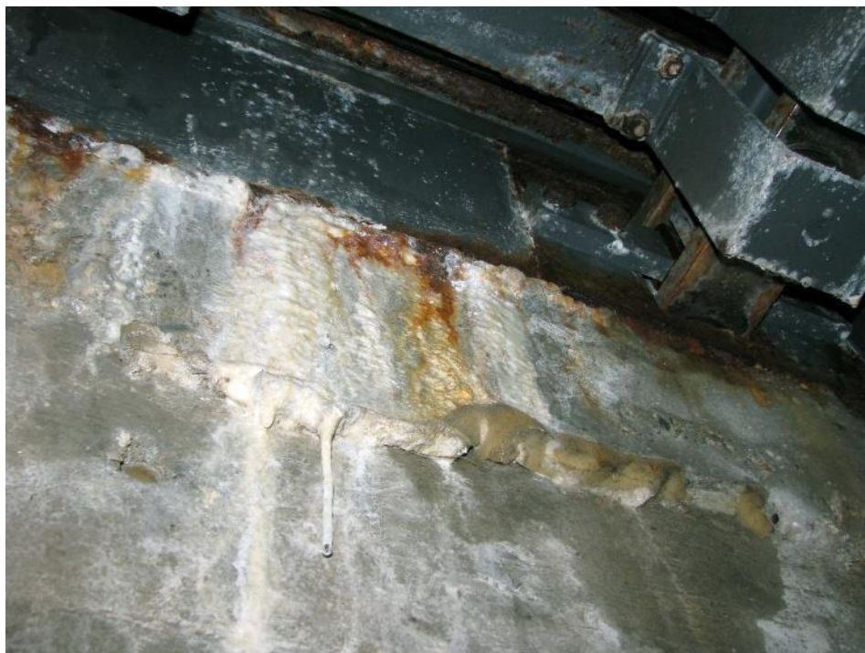
Slika 13.32: Resne poškodbe betona spodnje konstrukcije zaradi vodonetnosti tesnilnih trakov ali odpovedi priključka hidroizolacije vozišča k dilataciji
