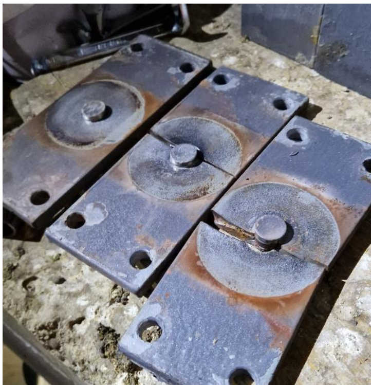
Slika 13.15: Zaradi resonance lamelne dilatacije, tudi zaradi premajhne togosti prekladne betonske konstrukcije je drsni in krmilni sistem dilatacije odpovedal (na sliki lom jeklenih podstavkov za drsna ležišča)
