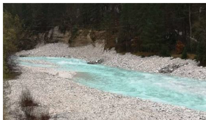
Izvedba točkovnih obrežnih zavarovanj -odbijačev, brez vmesnih utrditev na Soči pod Hovsnerjem (Hidrotehnik d.d., 2019)
