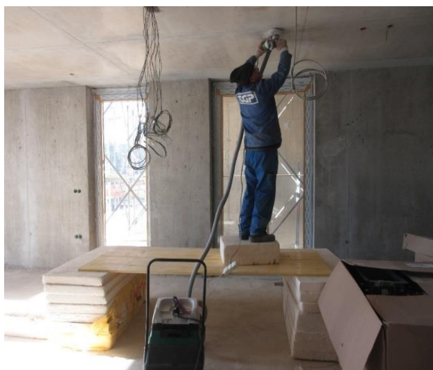
Slika 10: Neustrezno urejeno delovno mesto – improviziranje na gradbišču
