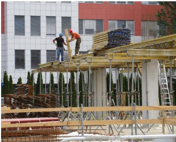
Slika 11: Nevarno izvajanje dela na višini
