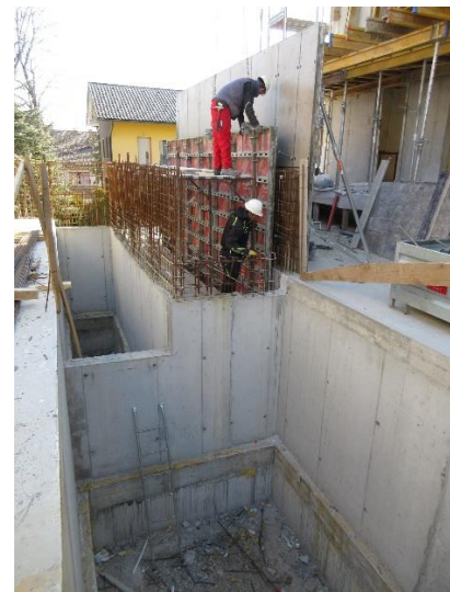
Slika 12: Nevarno izvajanje dela na višini
