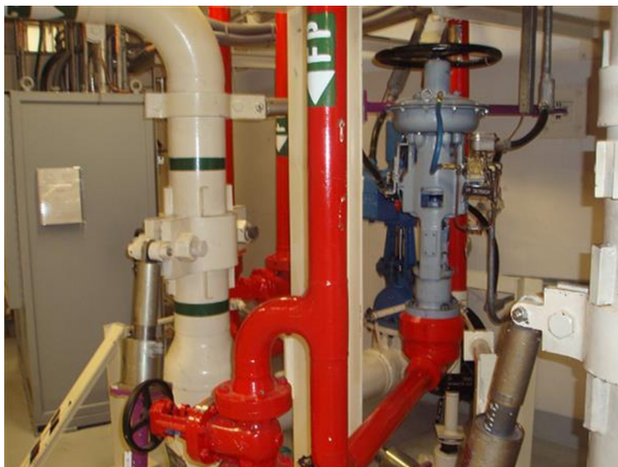
Slika 12: Protipožarni izolacijski ventil 28985 (ventil se nahaja na protipožarnem cevovodu za gašenje primarne črpalke št.1)
