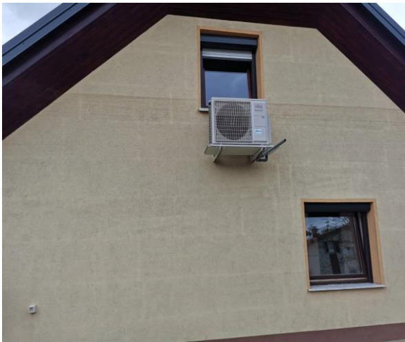
Fotografija 2: : Južna fasada – vidna linija vode na objektu
