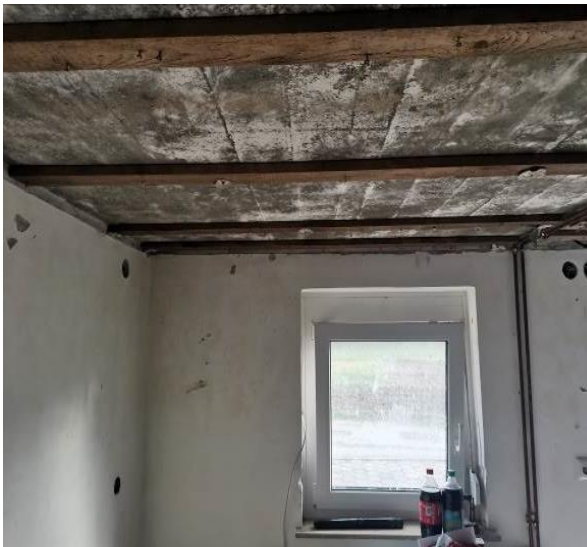
Fotografija 3: Pritličje (uničen strop – odpadel spuščeni strop)
