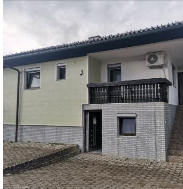
Fotografija 2: Pogled na fasado iz SV (vidna linija vode v 1. nadstropju)
