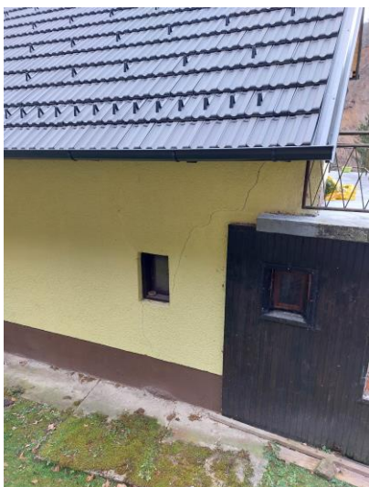
Fotografija 1: Vidna razpoka na zaledni strani objekta (5.1.2024).
