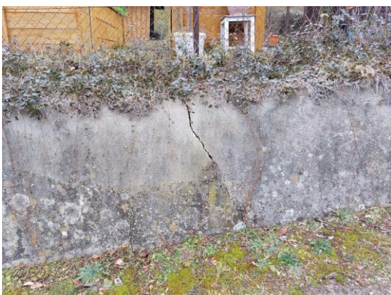
Fotografija 5: Pogled na poškodovano podporno konstrukcijo na območju vrtnih površin (5.1.2024).
