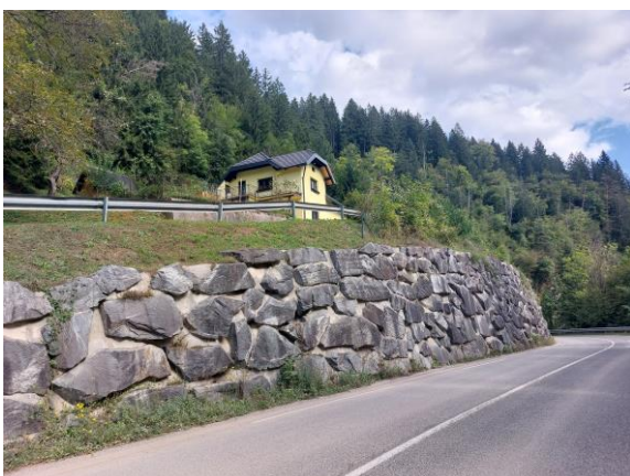
Fotografija 3: Podporna konstrukcija, ki se nahaja pod stanovanjskim objektom Raduha 53 oz. ob državni cesti Luče-Ljubno je močno razpokana na več mestih (5.10.2023).
