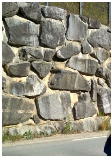
Fotografija 2: Pogled na močno poškodovano podporno konstrukcijo (5.10.2023).
