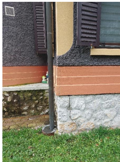
Fotografija 2: Večja razpoka na zunanji strani objekta (13.3.2024)
