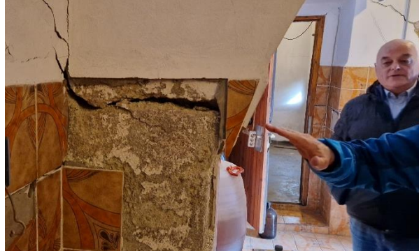
Fotografija 3: Močna strižna poškodba pete nosilnega loka
