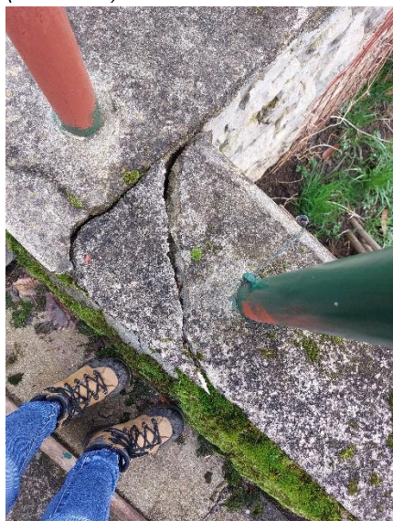
Fotografija 5: Odprte razpoke na betonskem zidu (13.3.2024)
