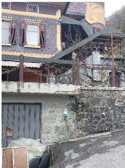
Fotografija 1: Močno razpokana stanovanjska hiša – Topolšica 124 (13.3.2024)
