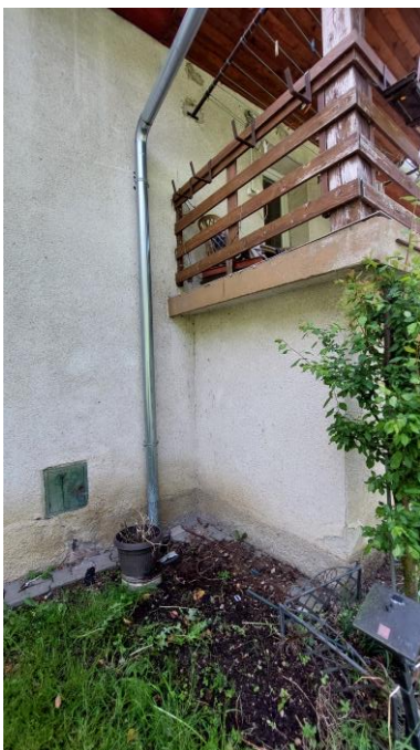
Fotografija 5: Razpoke na zgornjem delu objekta (19.4.2024).
