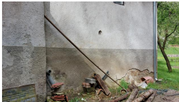
Fotografija 4: Razpoke na spodnjem delu objekta (19.4.2024).
