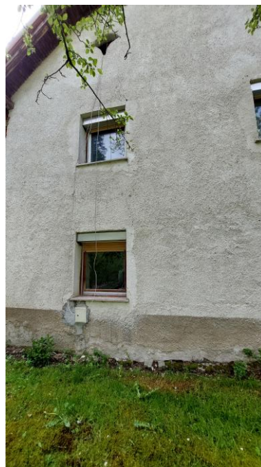
Fotografija 6: Razpoke tudi ob oknih, ki se ne dajo odpreti (19.4.2024).
