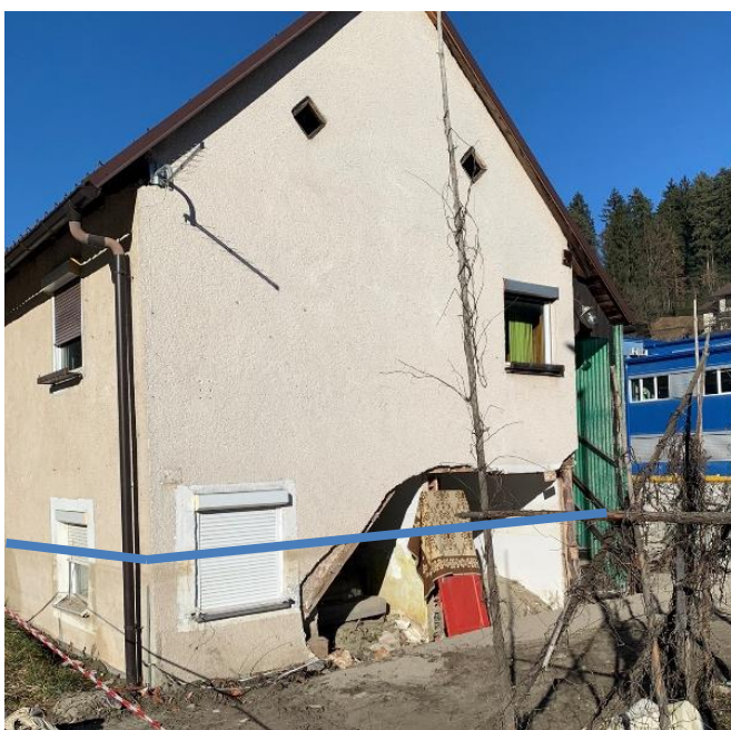
Slika 5: Objekt Mariborska cesta 3, Mežica po poplavih (vir: VGB Maribor d.o.o.)
