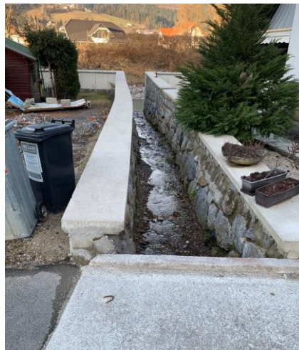
Slika 32: Izlivni odsek Gutmanovega potoka
