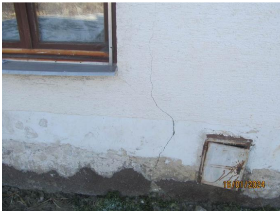
Fotografija 2: Vertikalna razpoka na nosilni steni
