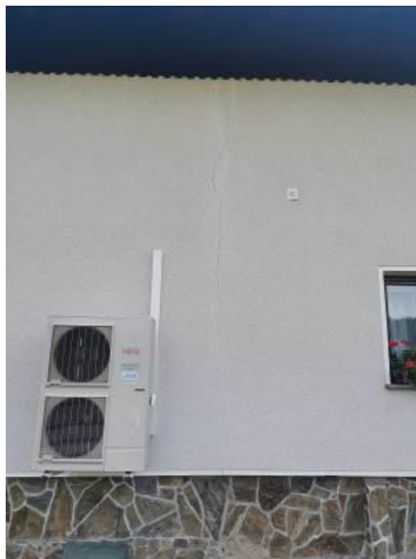
Fotografija 3: vertikalne razpoke na fasadi
