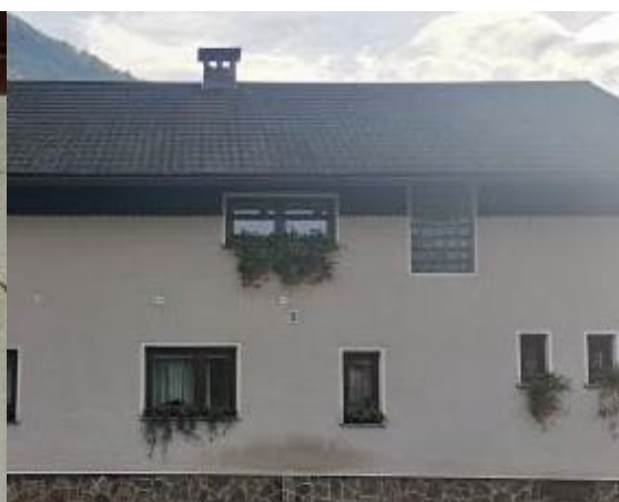
Fotografija 6: S fasada – vidna linija vode pod okni v pritličju
