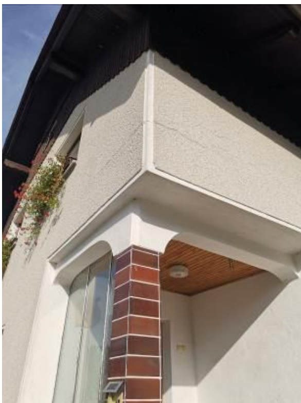
Fotografija 2: razpoke na vogalu hiše nad stebrom
