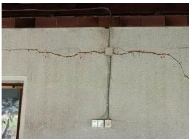
Fotografija 5: Razpoke na fasadi, posledica posedanja temelja na strani vodotoka
