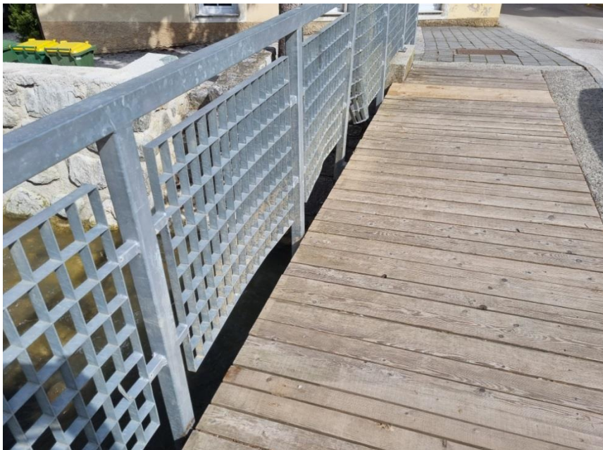
Slika 5: Sledovi poplave vode 4.8. na ograji mostu tik ob objektu Na Tratah 19 (prelivanje mostu z 20-30 cm vode, pljuskanje preko ograje)
