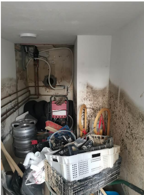
Fotografija 5: Detajl notranjosti - vidna linija vode v kotlovnici.
