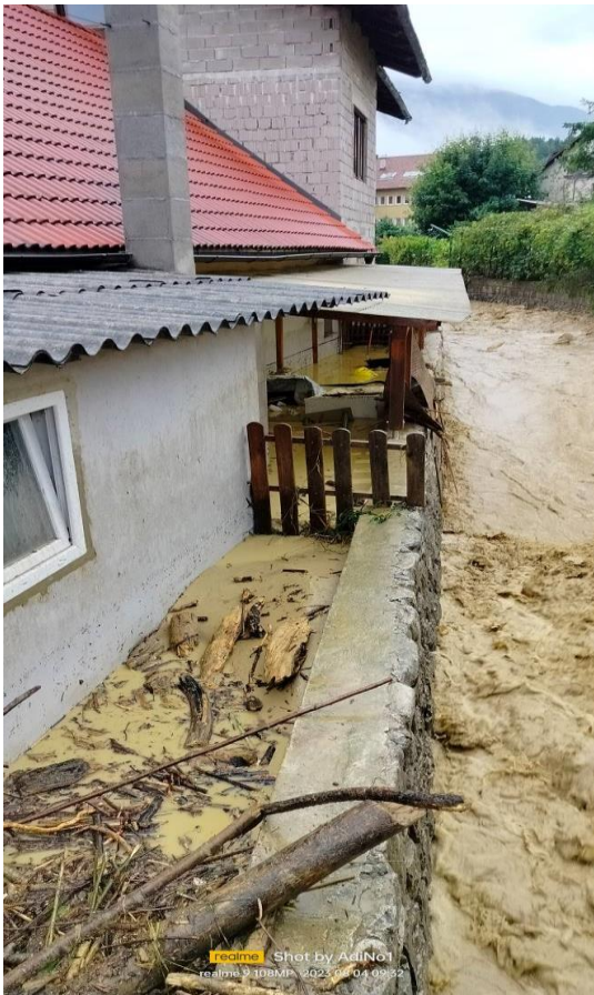
Fotografija 3: Stanje med poplavami dne 4.8.2023
