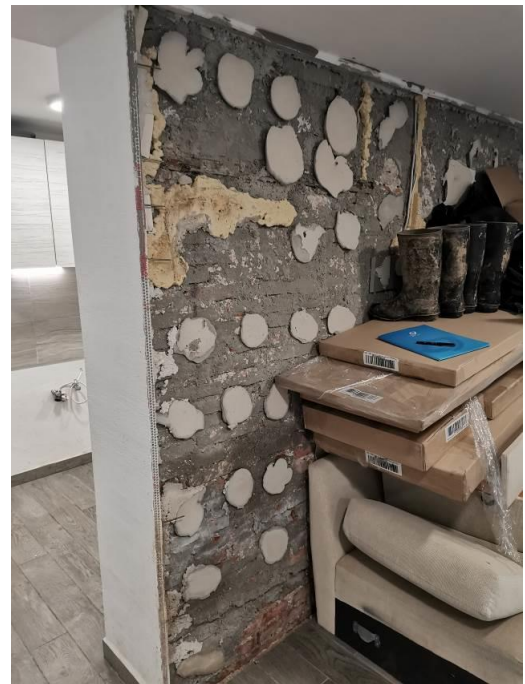
Fotografija 6: Poškodovana stena (napita z vodo, odpadla obloga).
