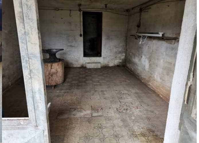
Fotografija 4: Notranjost kleti: zalita z vodo, napite stene, strop in uničen tlak.
