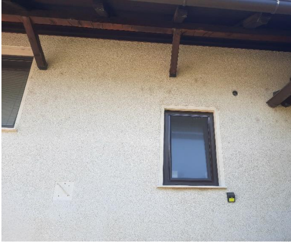
Fotografija 3: Horizontalna razpoka na zunanji južni steni v nivoju pritličja, vidna je višina poplavne vode sredi okna
