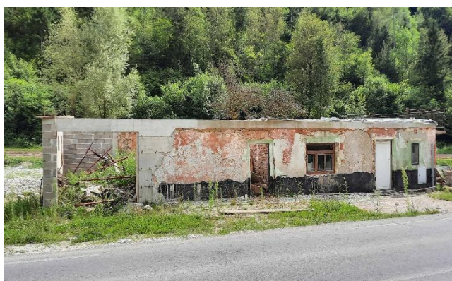
Fotografija 4: Pogled na vhodno, severno obcestno fasado po poplavah
