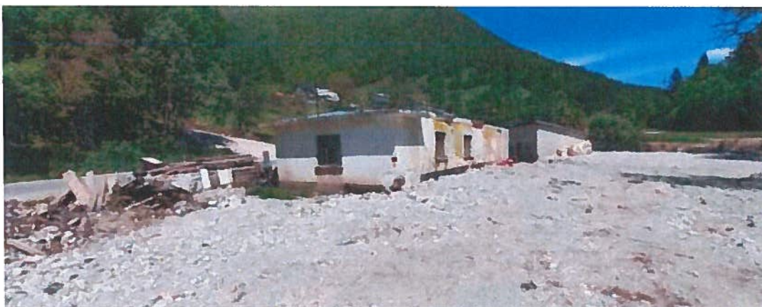
Slika 3: Prikaz stanja obravnavanega objekta (junij 2024), Potok v Črni 5, (foto: Banovec).
