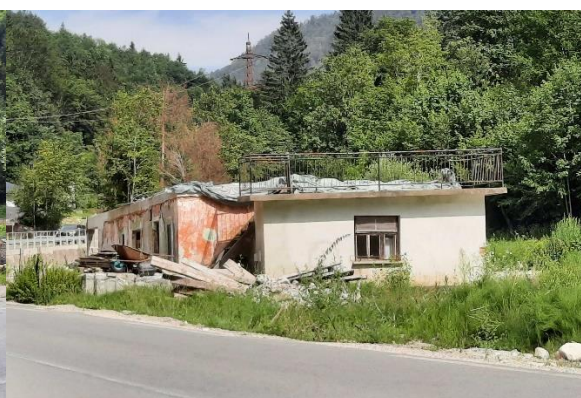
Fotografija 5: Pogled na zahodno, obcestno fasado po poplavah
