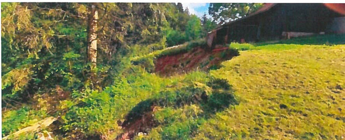
Slika 5: Prikaz ogroženosti objekta zaradi zemeljskega plazu (foto: Banovec).
