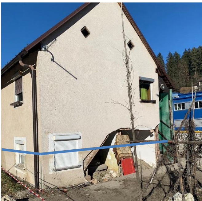
Slika 5: Objekt Mariborska cesta 3, Mežica po poplavah (vir: VGB Maribor d.o.o.)
