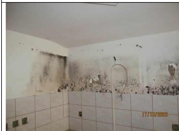
Pojav plesni na površini zidov zaradi zasičenosti z vodo v zidovih
