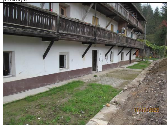
Pogled na pritličje v katerem so bila poplavljeni skupno tri stanovanja
