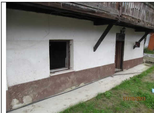
Evidentirana poplavna kota na fasadi
