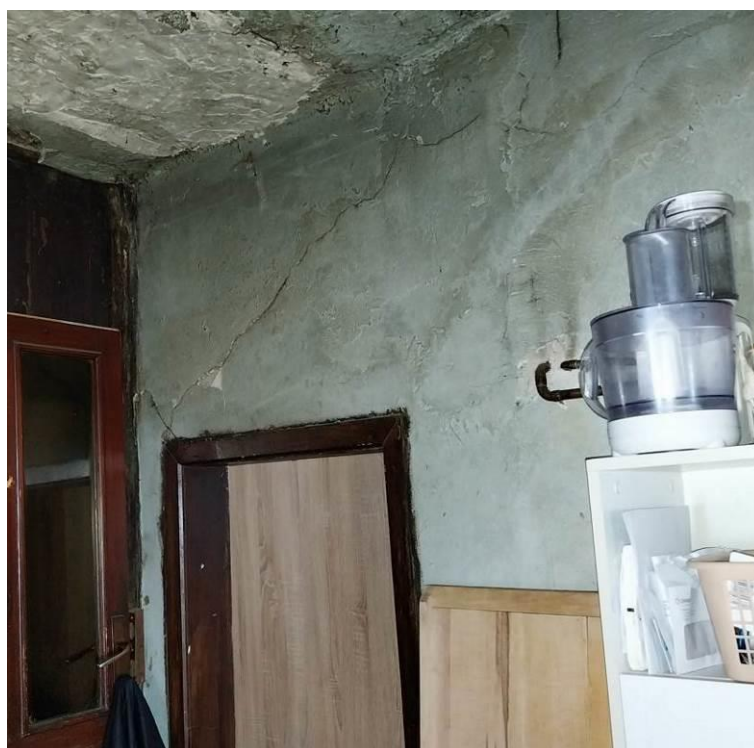
Slika 8 Arnače 14, poškodbe-razpoke v pritličju stanovanjskega objekta
