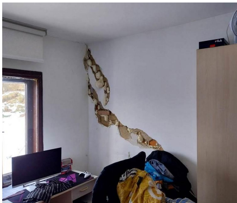
Slika 7 Arnače 14, poškodbe-razpoke v pritličju stanovanjskega objekta
