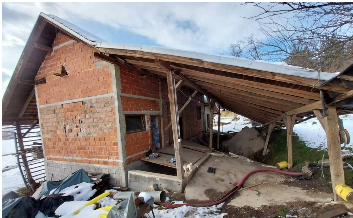
Slika 10 Arnače 14, močno poškodovano gospodarsko poslopje zaradi plazu
