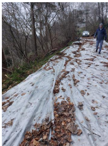
Fotografija 2: Razpoke na gozdni vlaki nad objektom Koroški Selovec 19 (27.11.2023).
