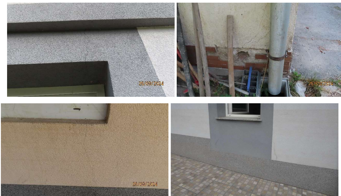
Slike 9,10, 11: znaki posedanja zidov: razpoke, ki izhajajo iz temeljev in razpoke na prekladah
