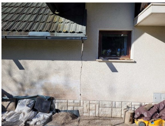
Slika 4: Razpoke na južni fasadi
