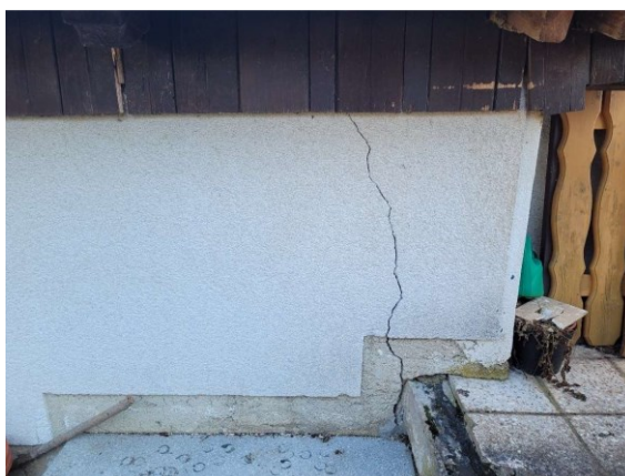
Slika 6: Razpoka na zahodni fasadi
