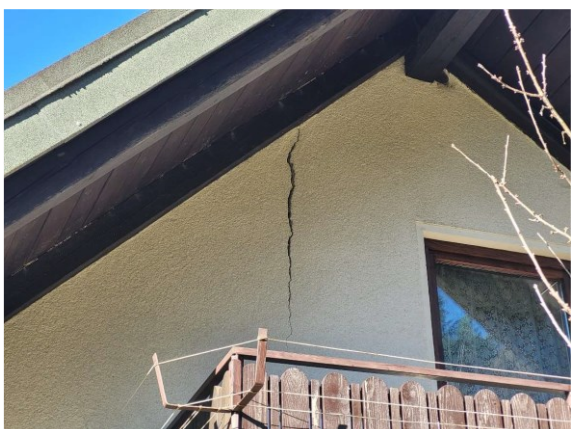
Slika 5: Razpoka na južni fasadi Mansarde
