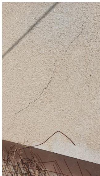
Fotografija 2: Poševne razpoke na hiši pred objektom – pri vhodu v klet (9.5.2024).
