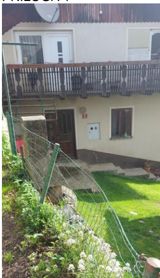
Fotografija 1: Poševne razpoke pri vhodu v objekt (9.5.2024)
