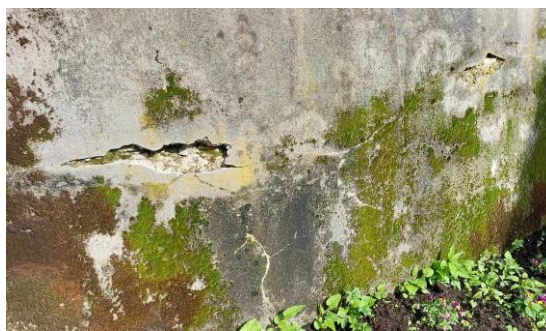
Fotografija 4: Zamakanje in vidne poškodbe na betonskem zidu (9.5.2024).
