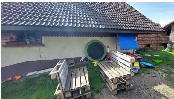
Fotografija 3: Poševne razpoke za objektom.(9.5.2024)
