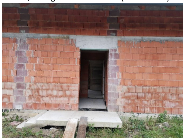
Slika 3 : Pritličje S stran (vidna linija vode v pritličju) – 19.10.2023
