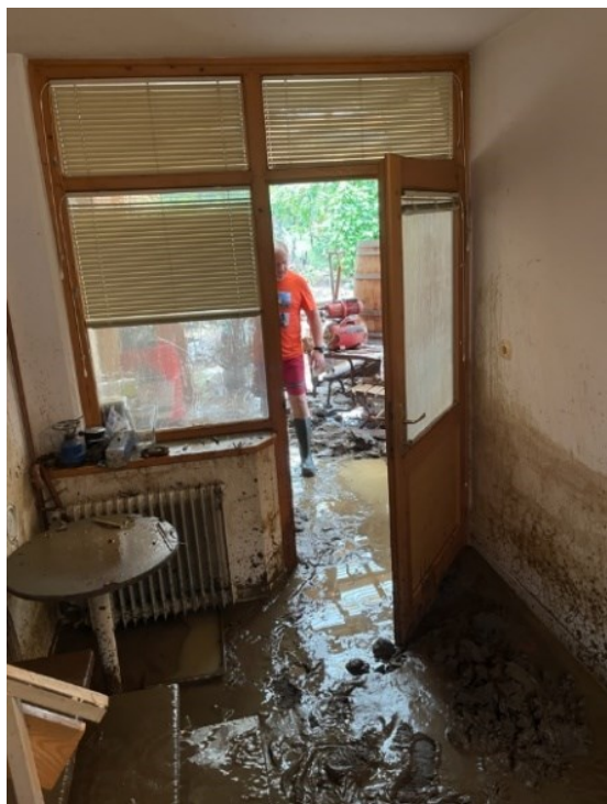
Slika 2 in 3: Stanje objekta po poplavi
